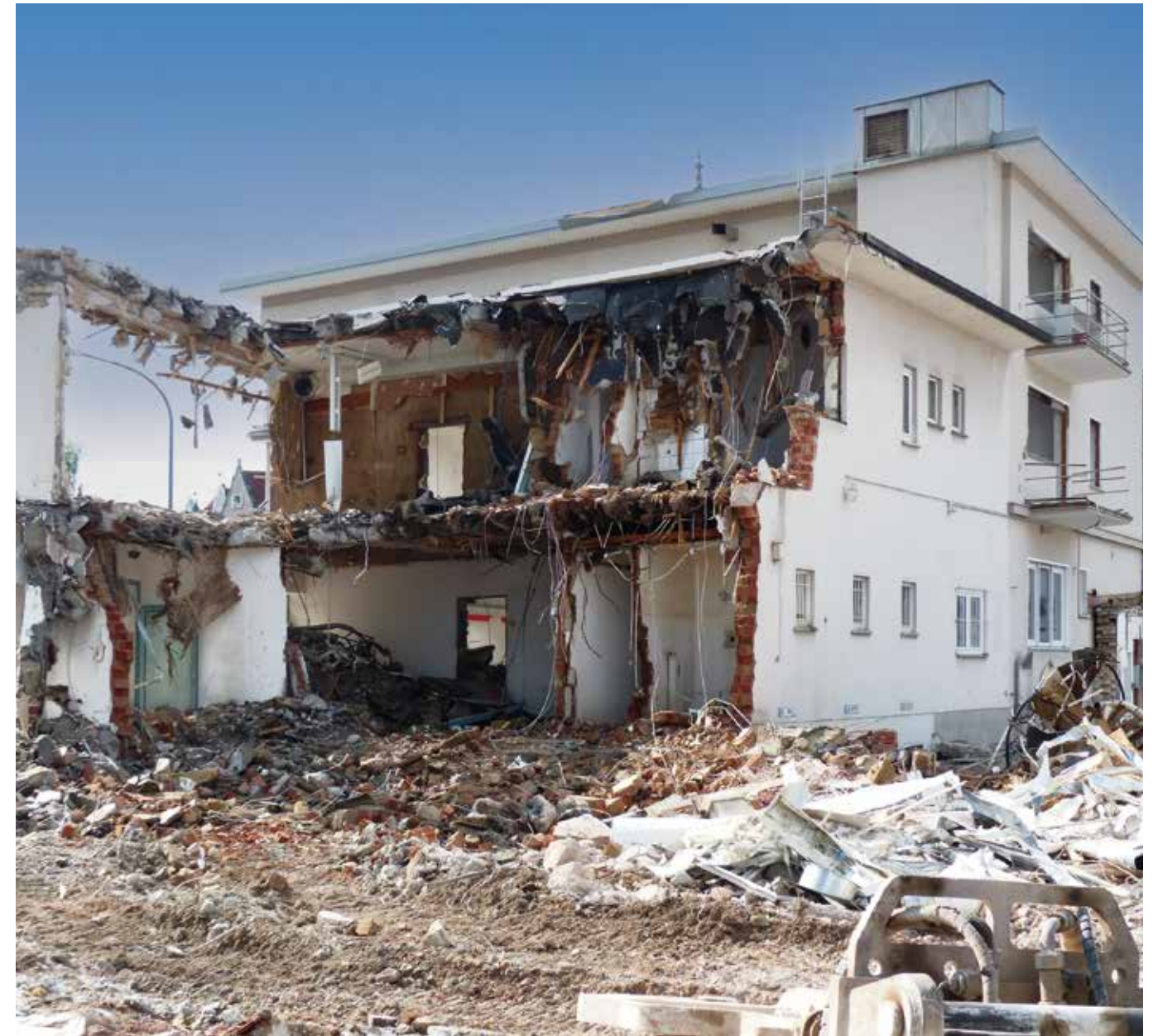
Abbruch von Gebäuden nach nur 10 - 15 Jahren als Beispiel für die Vergeudung unserer Ressourcen. Kunst bietet einen Anreiz einen längerfristigen Erhalt eines Gebäudes zu ermöglichen.
